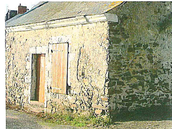
Murs en moellons présentant des désordres affectant la stabilité de la construction.
