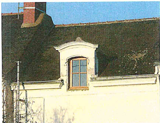
Lucarne à corniche cintrée, et corniche interrompue sur une façade du XVIII e siècle.
